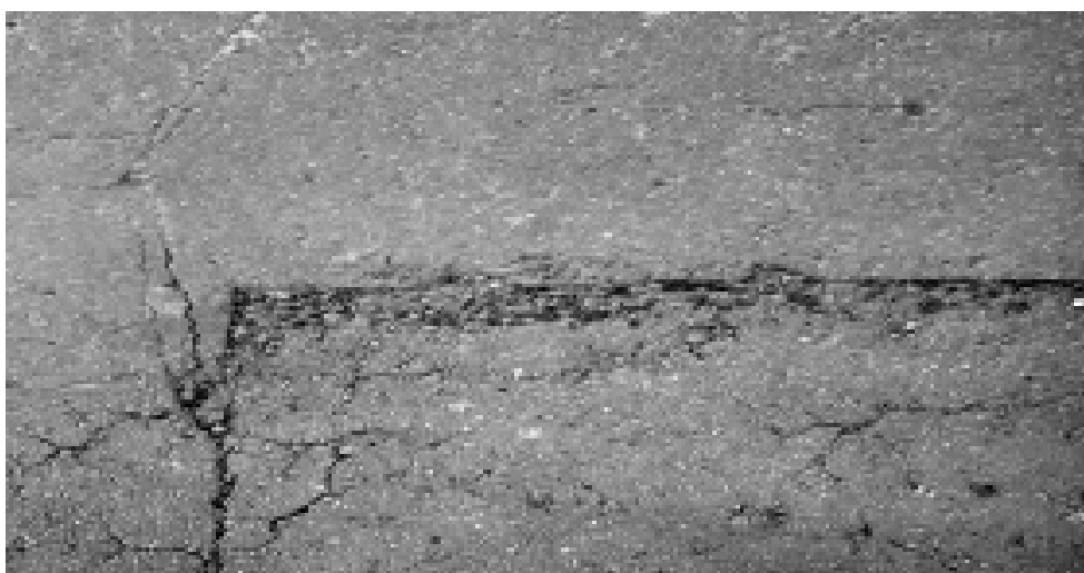
Рисунок 14 – Руйнування асфальтобетону у вибоїні
