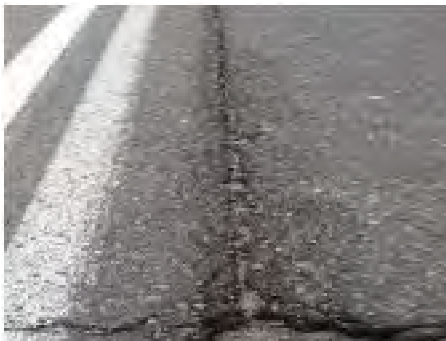
Рисунок 3 – Руйнування покриття в зоні технологічної тріщини
